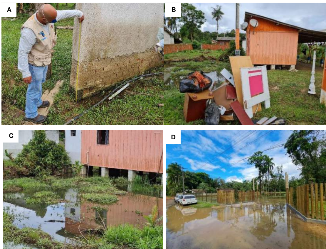
Figura 22: Vila das Palmeiras após inundação em 2021. A) Marcação do nível d'água de 1,5m; B) Móveis perdidos; C e D) Represamento dois dias após o evento. (Imagens: Renato Lima, 2021).
