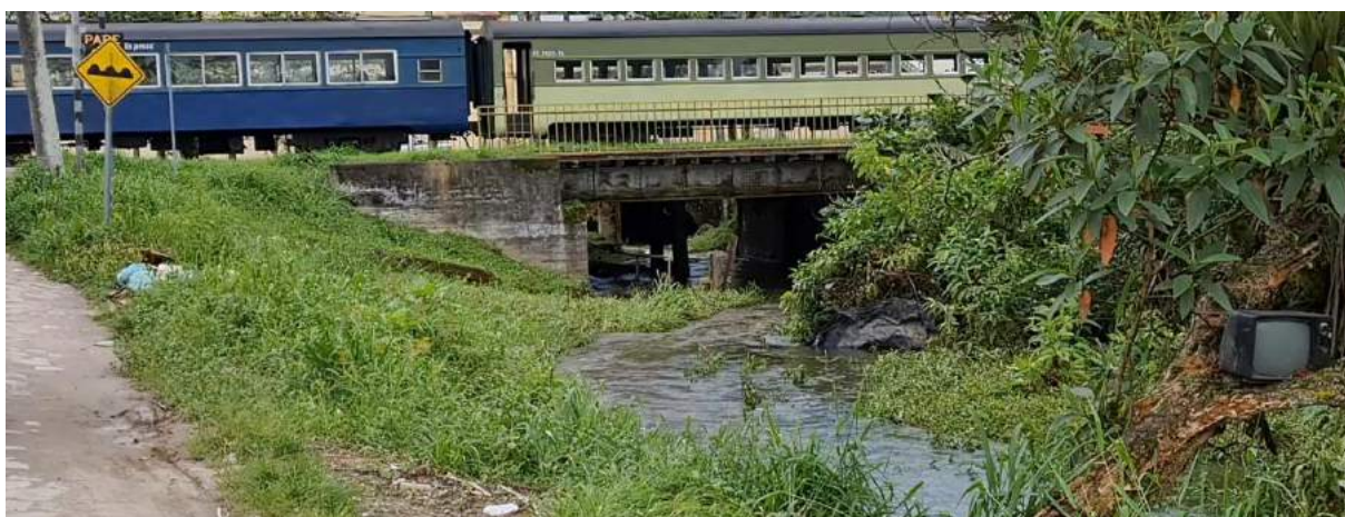
Figura 17: Trecho parcialmente canalizado de drenagem no Bairro Rocio. (Imagem: Renato Lima, 2021)
