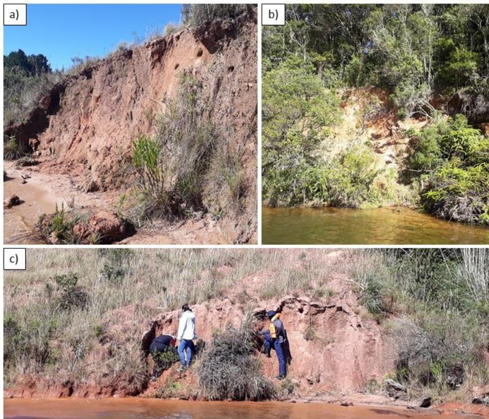
Figura 44: Borda do reservatório Piraquara I com possibilidade de aplicação de paliçada como métodos de contenção aos processos erosivos. a) Ponto 1 com alta declividade na margem. b) Ponto 5 com deslizamento acarretado pela erosão por ondas. c) Ponto 3 com alta declividade da margem e erosão por ondas gerando solapamento.
