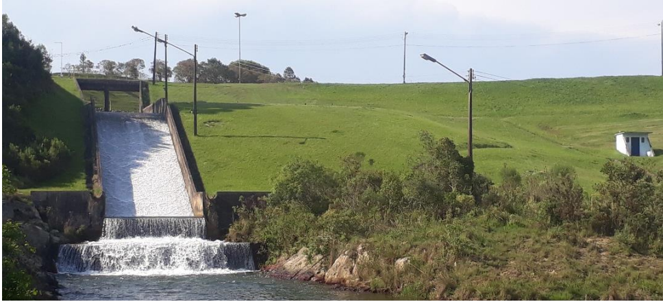
Figura 39: Extravasamento da água do reservatório Piraquara I pelo vertedouro identificado na segunda e terceira etapas de campo.
