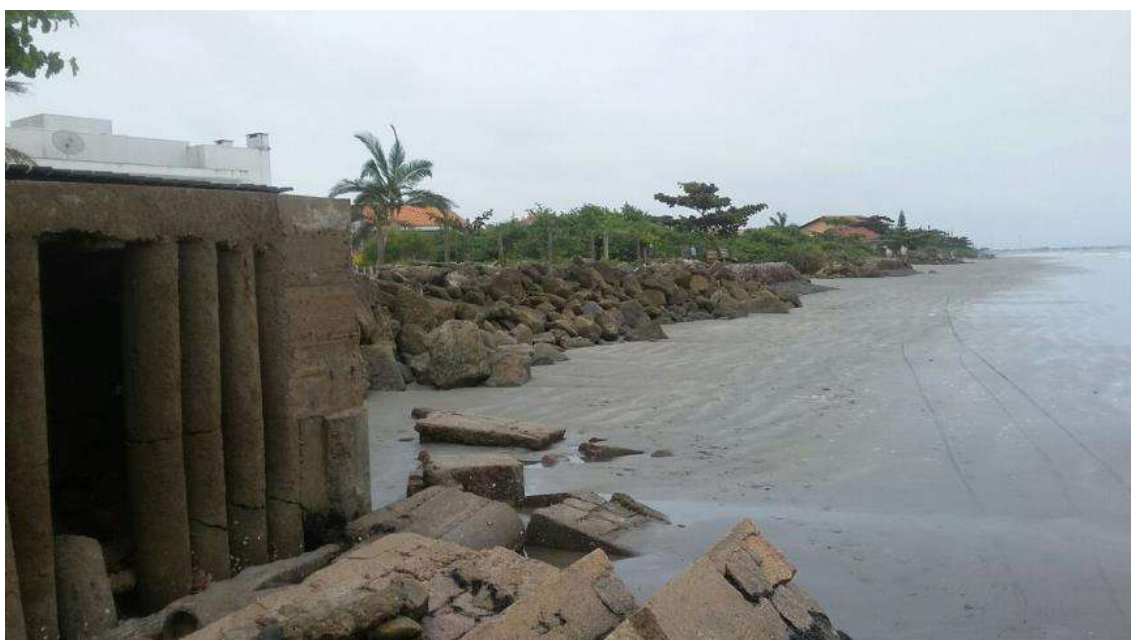
Figura 22 - Imagem ilustrando a erosão de construções na região próximo ao Pontal em maio de 2016 (foto do autor).
