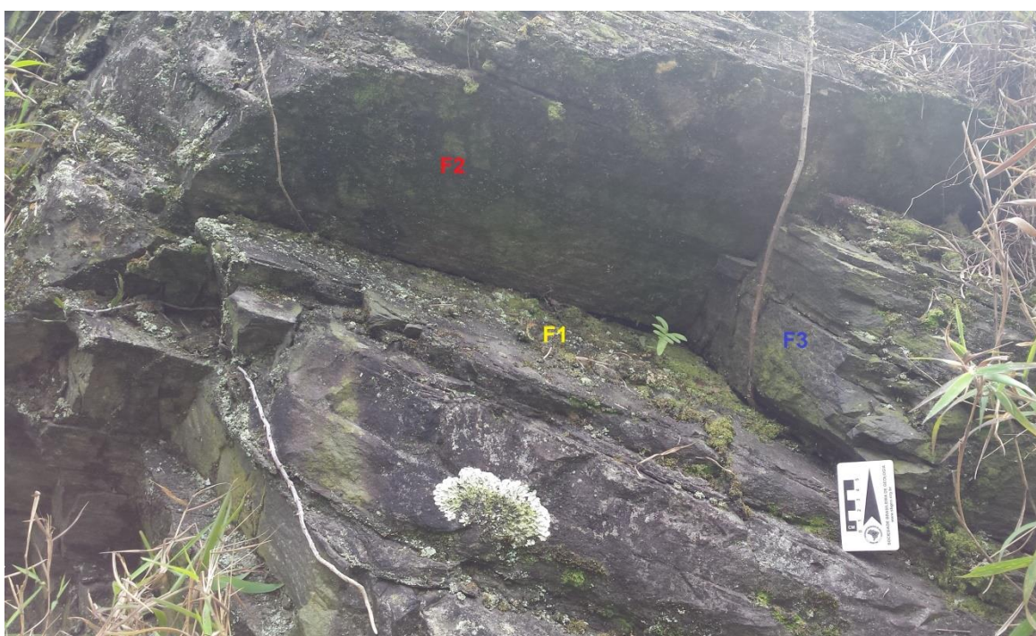
FIGURA 22: FORMAÇÃO DE CUNHA NO TALUDE SUL. FONTE: AUTORIA PRÓPRIA, 2016.
