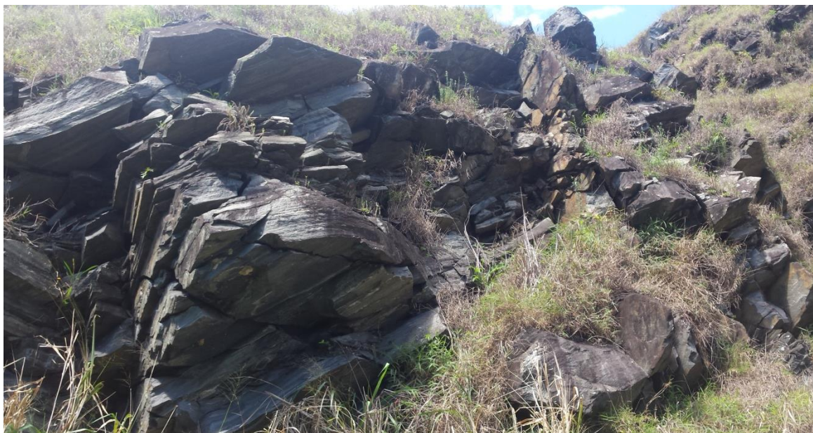
FIGURA 20: TALUDE NORTE À DIREITA DA RODOVIA. NOTA-SE BLOCOS DE ROCHA SOLTOS COM RISCO DE QUEDA. FONTE: AUTORIA PRÓPRIA, 2016.
