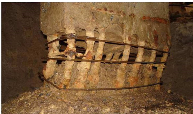
Figura 12. Caso de RAA em estado avançado em pilar de prédio. Fonte: Lima (2009).
